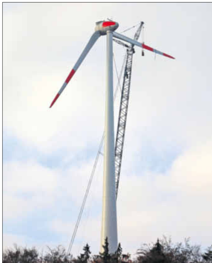
In Neuerkirch (Rheinland-Pfalz) errichtet die Thüga Erneuerbare Energien acht Enercon E-82 E2 Windkraftanlagen
